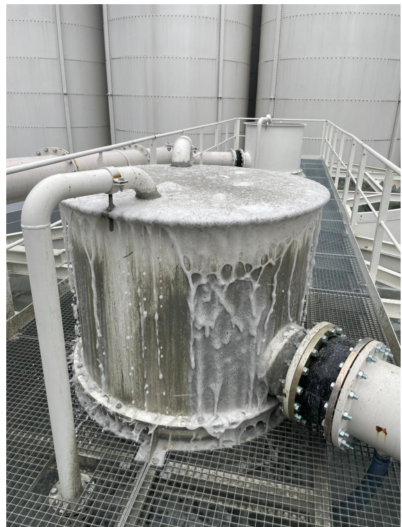
Schiuma visibile in sommità sull'apparecchiatura.
