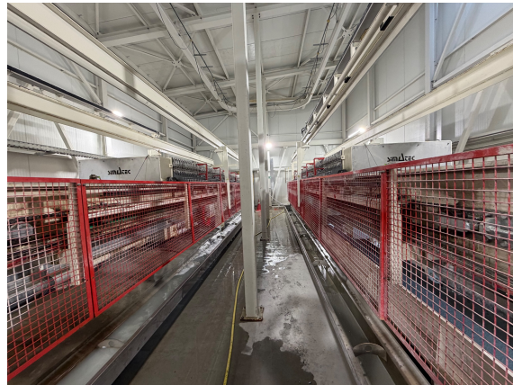
Filtro presse utilizzate nella fase di disidratazione.
